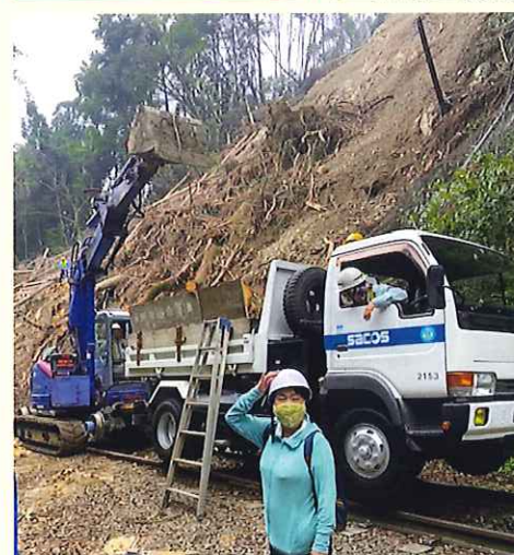
(2020/8/9 鞍馬二ノ瀬山林崩落現場)
